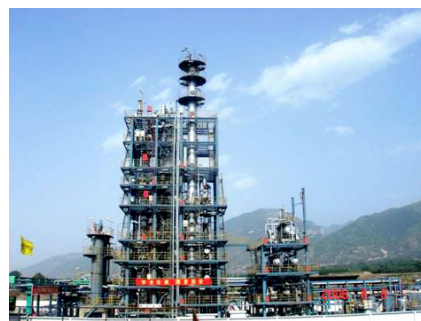
甲醇制烯烃(DMTO)工业性试验装置
